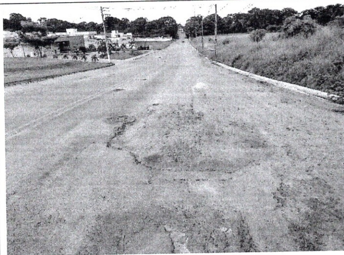
FOTO 03 – AVENIDA APRESENTA BURACOS EM ALGUNS TRECHOS.
