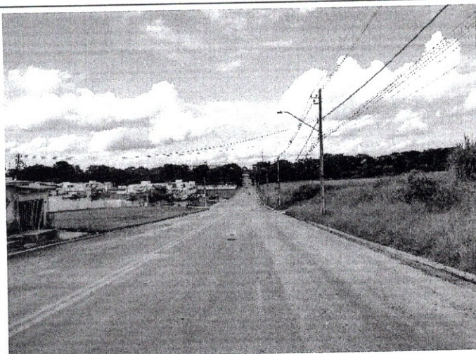
FOTO 02 – SINALIZAÇÃO HORIZONTAL ESMAECIDA.
