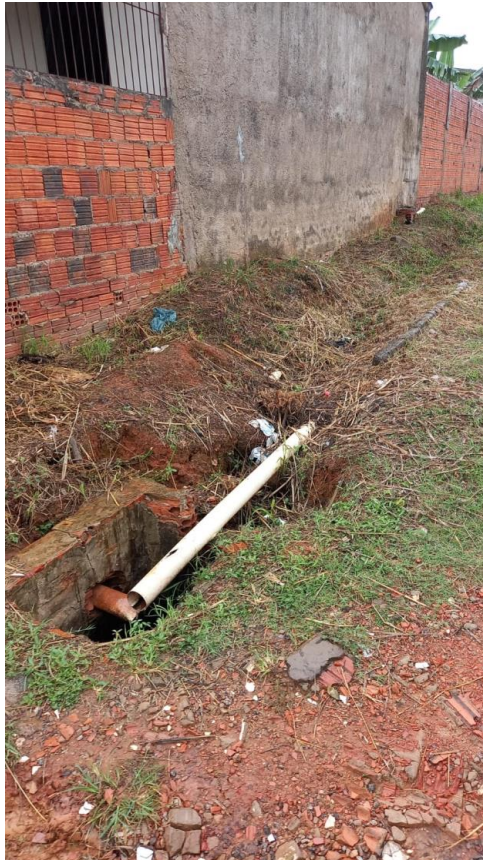
Figura 1 – Pavimentação com buracos e esgoto cheio(entupido).
