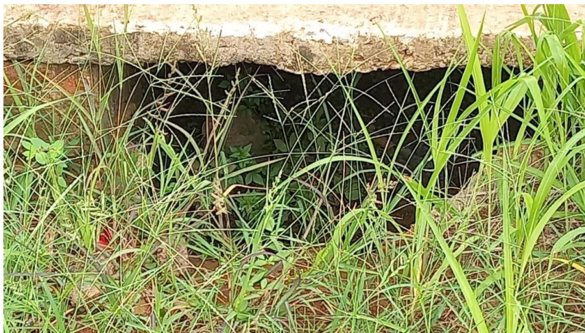
Figura 1 – Pavimentação com buracos.
