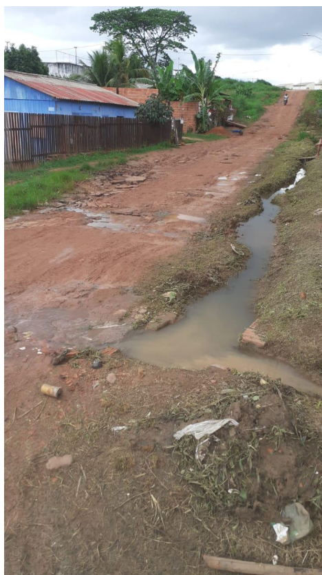
Figura 1 – Rede de esgoto com problemas.
