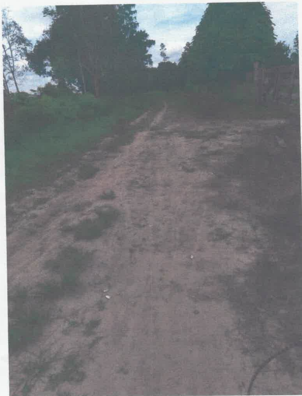
Figura 2 – Parte do ramal de difícil trafegabilidade.
