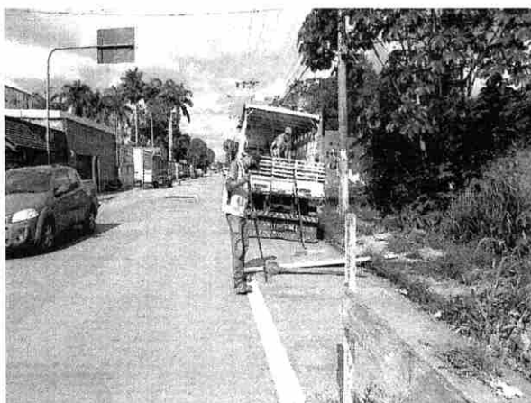
FOTO 01 – Implantação de sinalização com cavaletes no desbarrancamento
