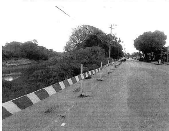
FOTO 03 - Implantação de sinalização com cavaletes no desbarrancamento
