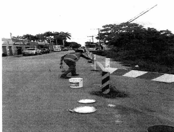
FOTO 02 – Implantação de sinalização com cavaletes no desbarrancamento
