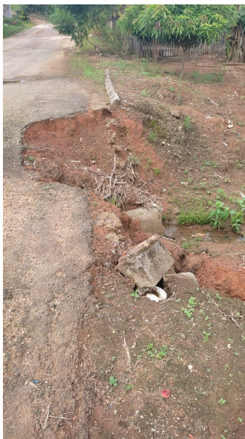
Figura 1 – Necessidade de manutenção na Rede de esgoto.
