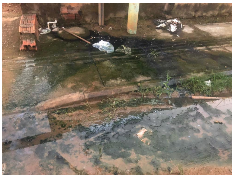
Figura 1 – Necessidade de manutenção na Rede de esgoto.
