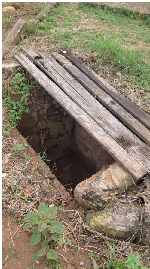
Figura 1 – Necessidade de manutenção na Rede de esgoto.
