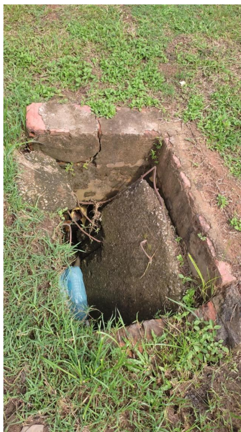
Figura 1 – Necessidade de manutenção na Rede de esgoto.
