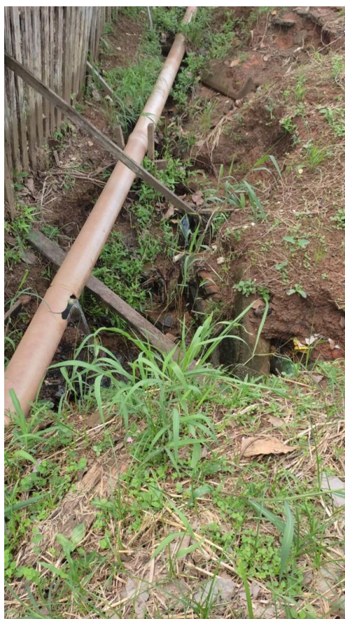
Figura 1 – Necessidade de manutenção na Rede de esgoto.
