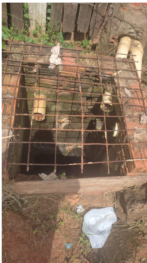
Figura 1 – Necessidade de manutenção na Rede de esgoto.
