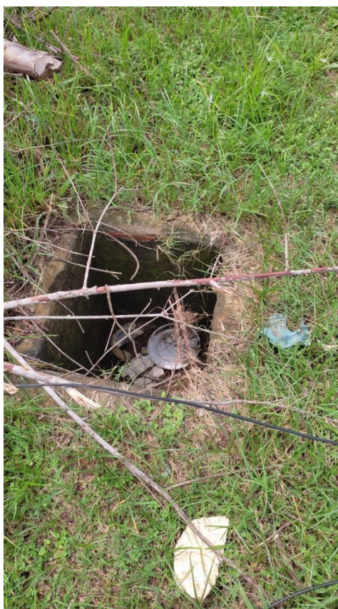
Figura 1 – Necessidade de manutenção na Rede de esgoto.
