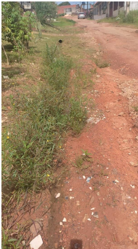
Figura 1 – Necessidade de manutenção na Rede de esgoto.
