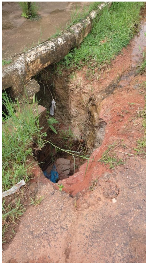
Figura 1 – Necessidade de manutenção na Rede de esgoto.
