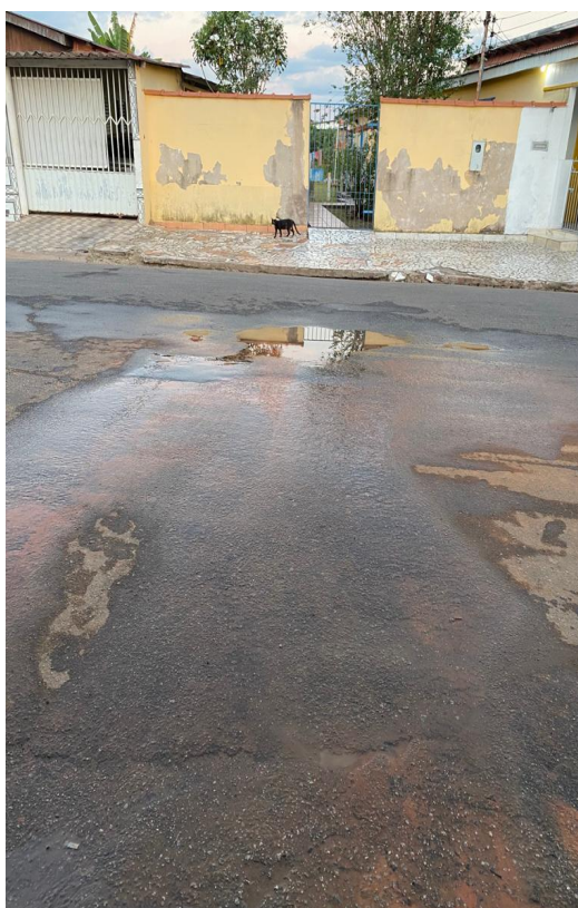
Figura 1 – Rua com rede de água estourado
