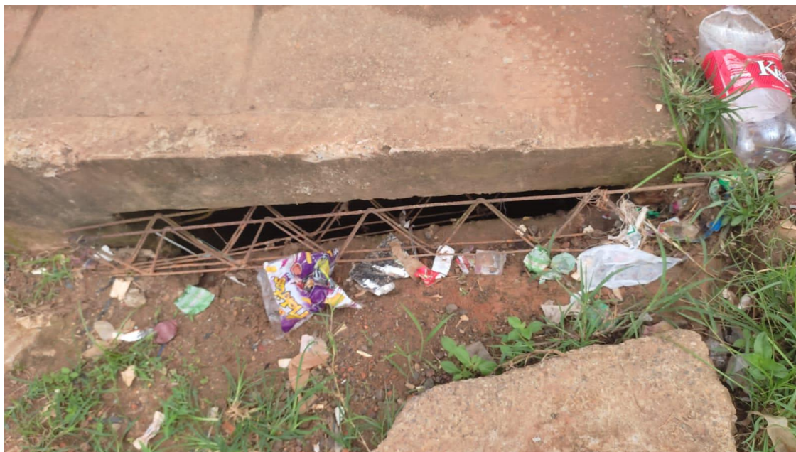
Figura 1 – Necessidade de manutenção na Rede de esgoto.
