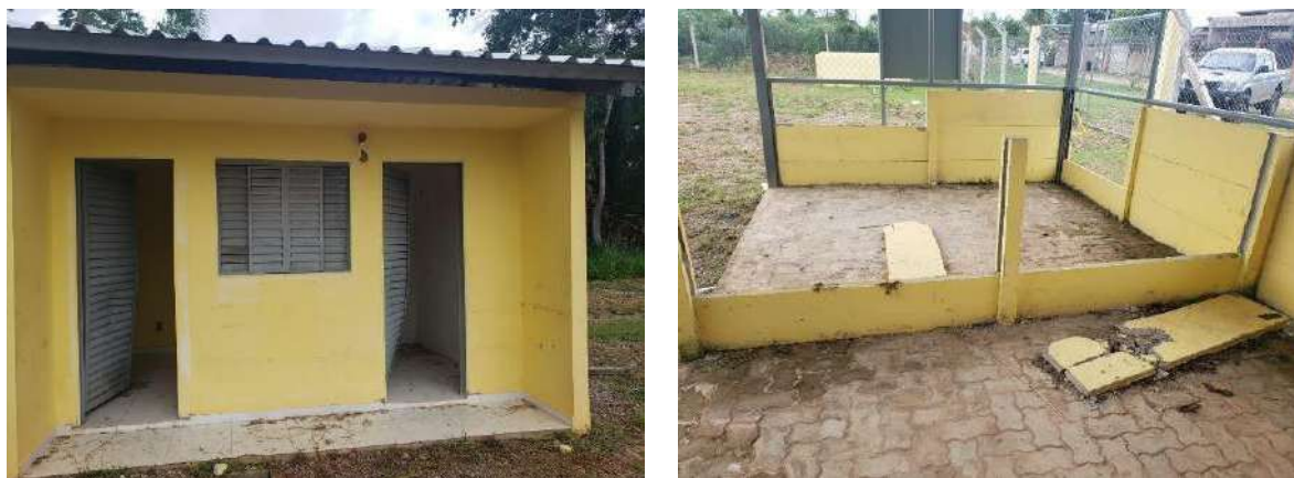
Figura 65. Estrutura do escritório administrativo do Ecoporto Conquista depreciado (portas, baias, telhado e cercamento) em novembro de 2021
