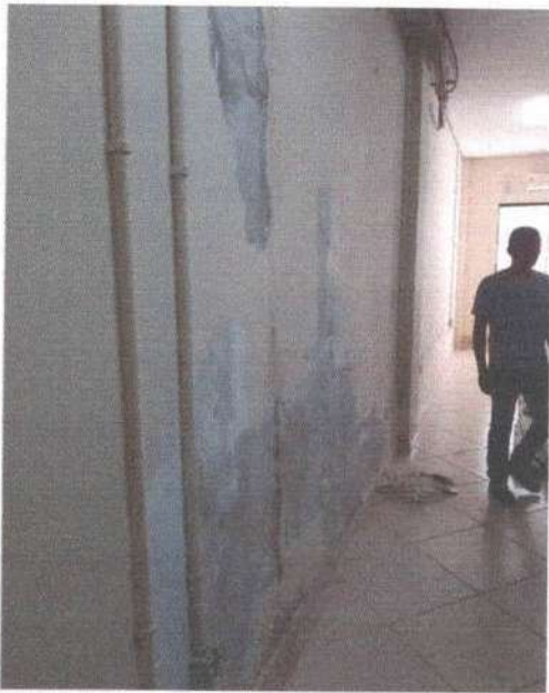
Foto 1: parede com mofo
