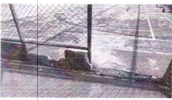
Foto 103 – mureta da quadra danificada
