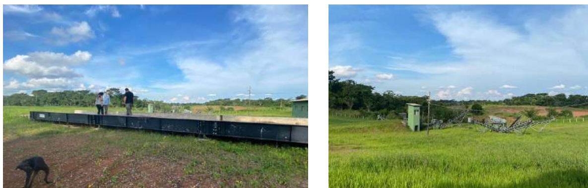
Figura 66. Equipamentos instalados na Área de Triagem, Transbordo e Reciclagem – ATTR, com destaque na balança rodoviária e Britador de RCC, em 22 de fevereiro de 2021
