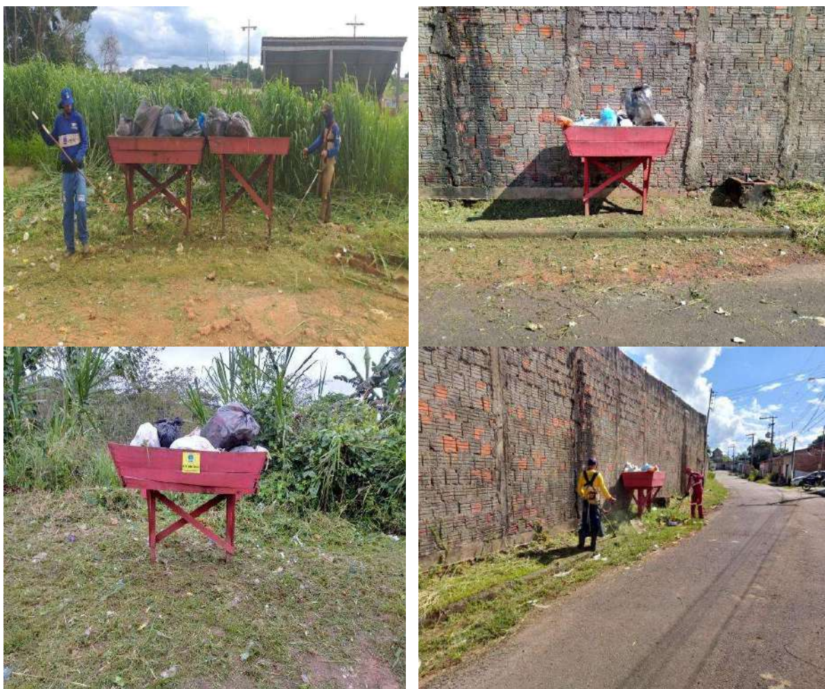
Figura 8 – Instalações de jirais em substituição aos danificados pela ação do sol e da chuva
