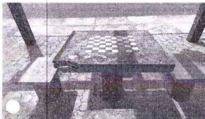
Foto 97 -mesa danificada e com desgaste na pintura
