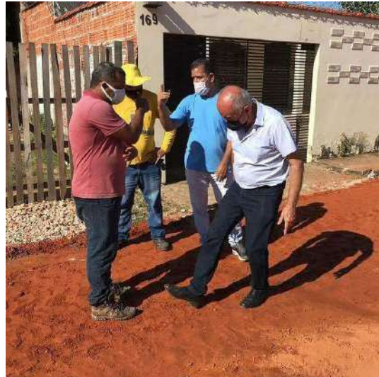
Visita técnica a obra de recuperação de ruas no Bairro Cadeia Velha, ocorrida em 16/7/2021.
