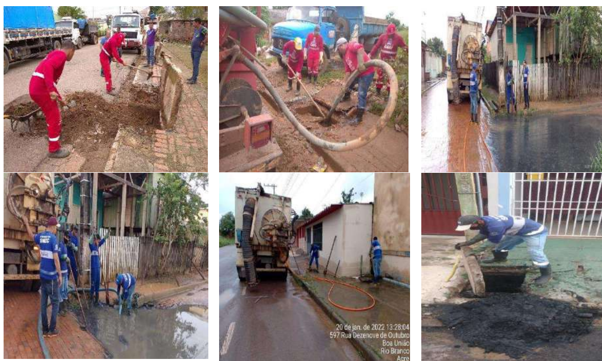
Figura 4 – Desobstrução manual de rede de drenagem de águas pluviais com retirada de entulhos
