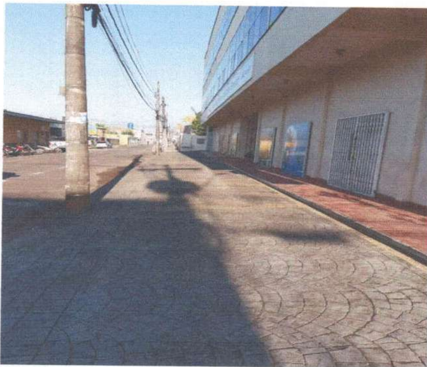
Foto 7 – calçada do prédio sede da SEGATI antes da reforma
