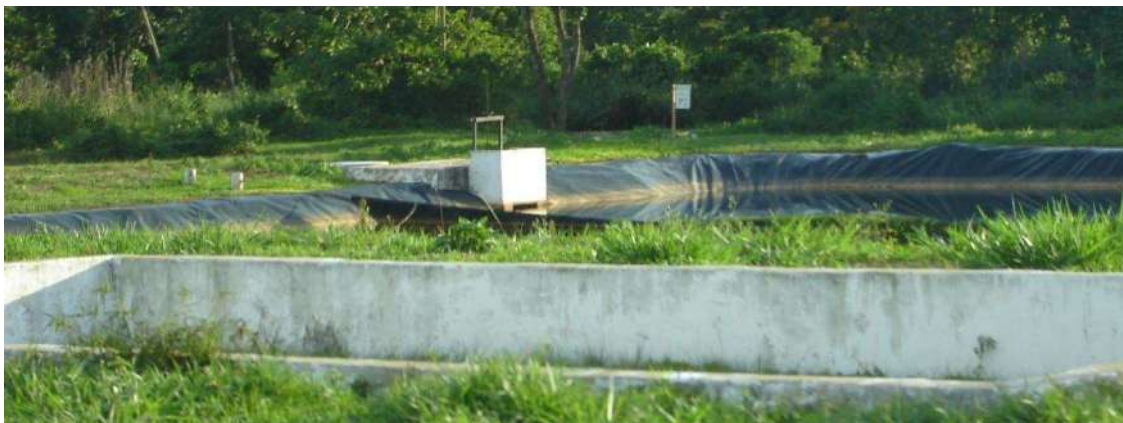
Figura 14 – Lagoa de tratamento do Aterro Sanitário localizada na UTRE.
