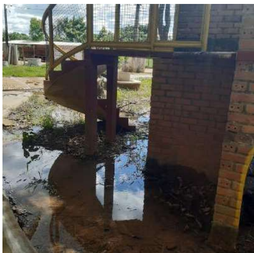
Figura 122. Registro do problema de drenagem na área de playground
