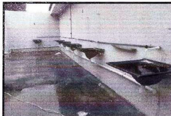
FIGURA 15 – Tanques Para Higienização Na Cozinha
