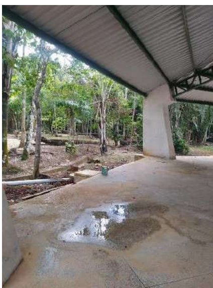
Figura 120. Registro da construção em andamento da Praça de Alimentação, evidenciando a goteira do telhado e a falta de acabamento do piso da construção da Praça de Alimentação do Parque Ambiental Chico Mendes.
