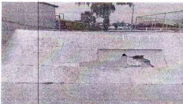
foto 115 - rampa do skate park danificado
