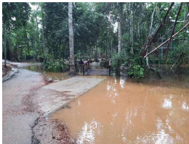
Figura 124. Registro do problema de drenagem no bosque das aves
