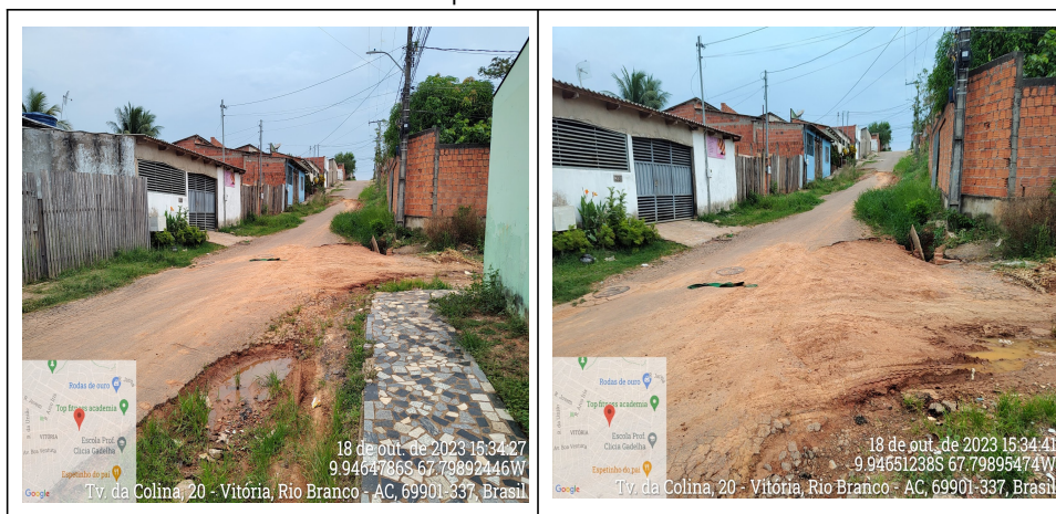
Figura 1 e 2. Constatação da identificação do objeto de requisição e das condições precárias dos dispositivos vistoriados
