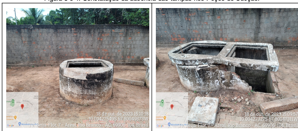
Figura 3 e 4. Constatação da ausência das tampas nos Poços de Sucção.
