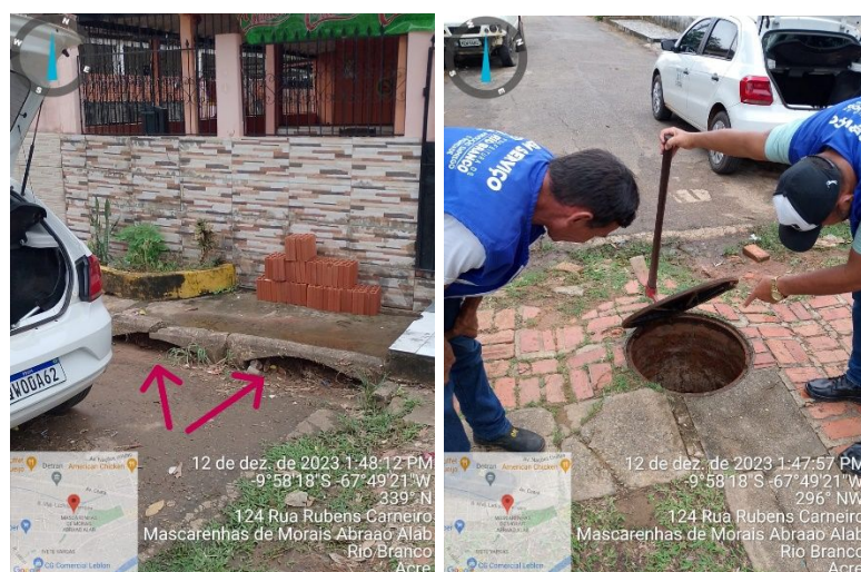
Imagem 6 – Drenagem obstruída e PV desobstruído.
