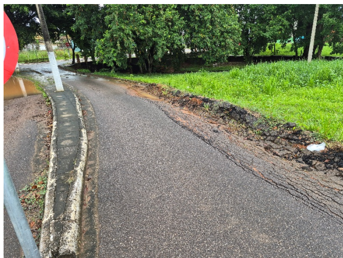
FOTO 01 – BURACOS NA VIA
