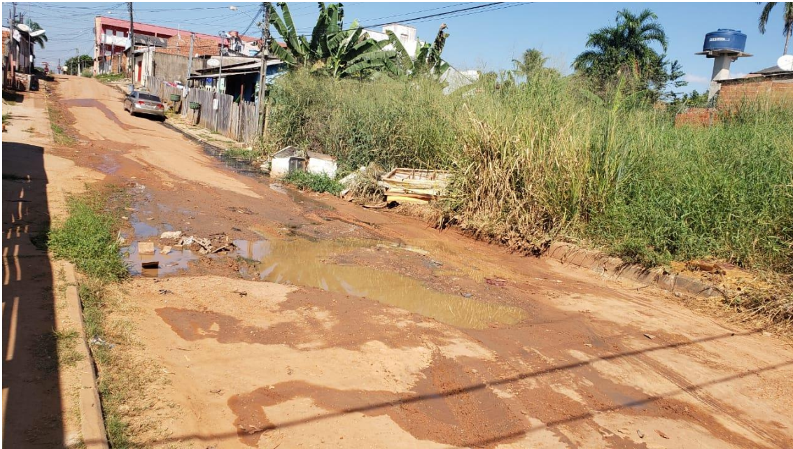
Figura 1 – Rua quase sem acesso e coleta de lixo comprometida.
