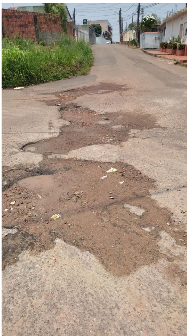
Figura 1 – Pavimentação com buracos e necessidade de limpeza.
