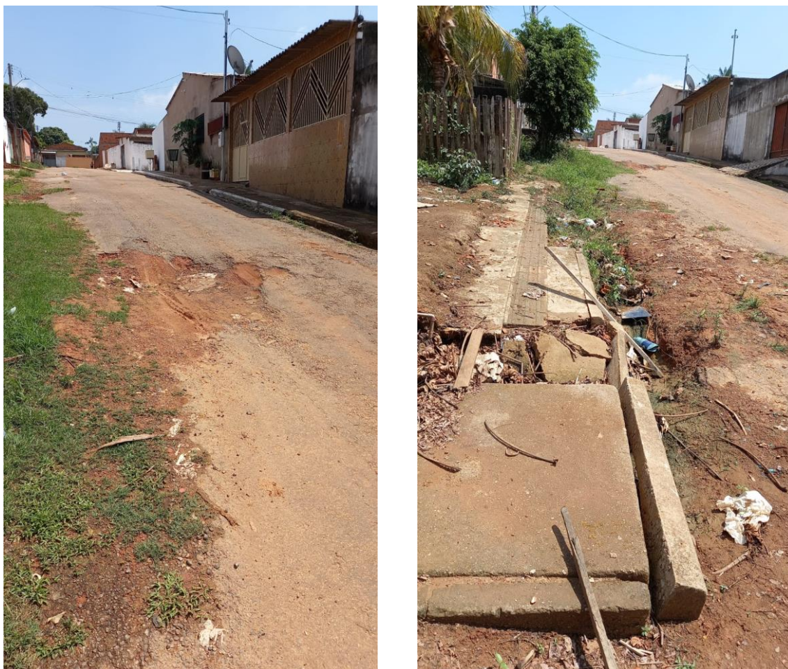
Figura 1 – Pavimentação com buracos.
