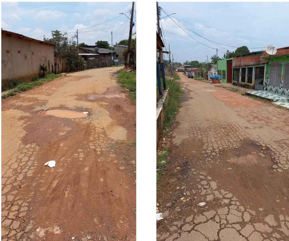
Figura 1 – Pavimentação com buracos.
