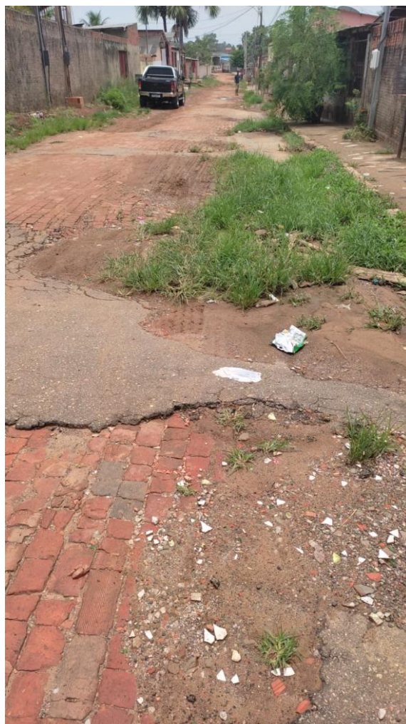
Figura 1 – Pavimentação com buracos.
