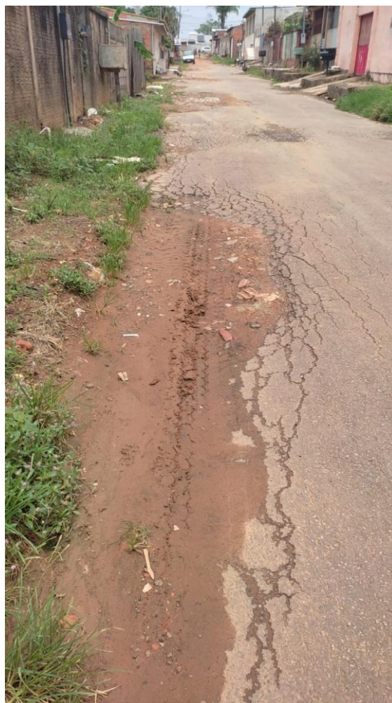
Figura 1 – Pavimentação com buracos.
