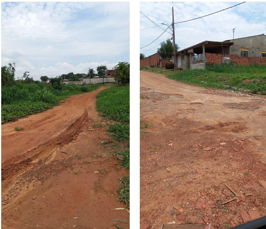
Figura 1 – Pavimentação com buracos.
