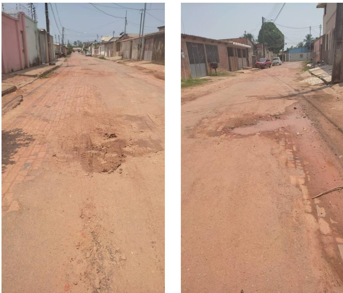
Figura 1 – Rua necessita da manutenção em sua pavimentação.
