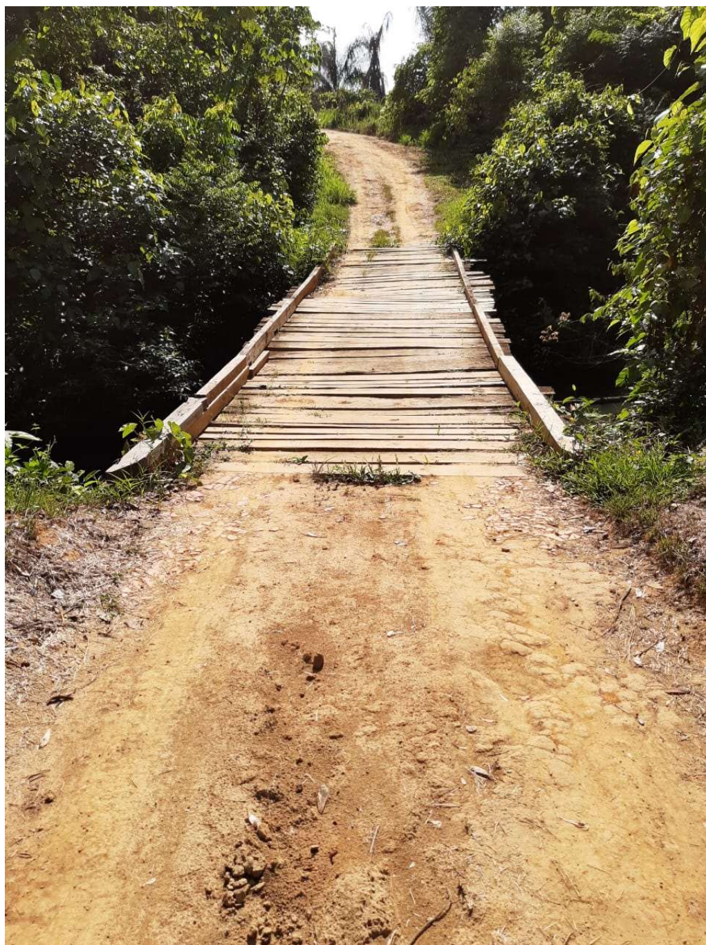
Figura 1 – Ponte que necessita de manutenção em sua estrutura.
