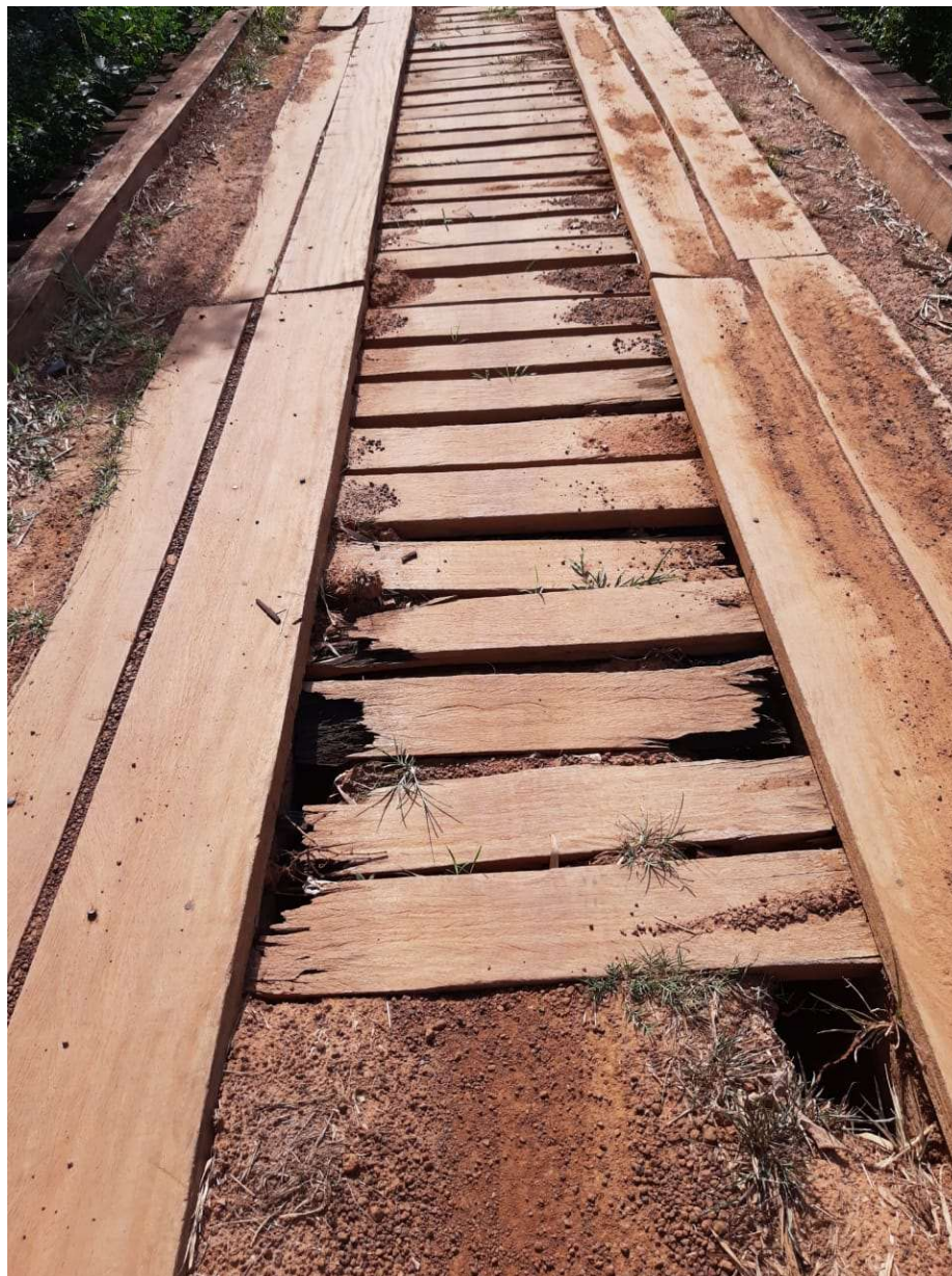
Figura 2 – Ponte em estado precário.
