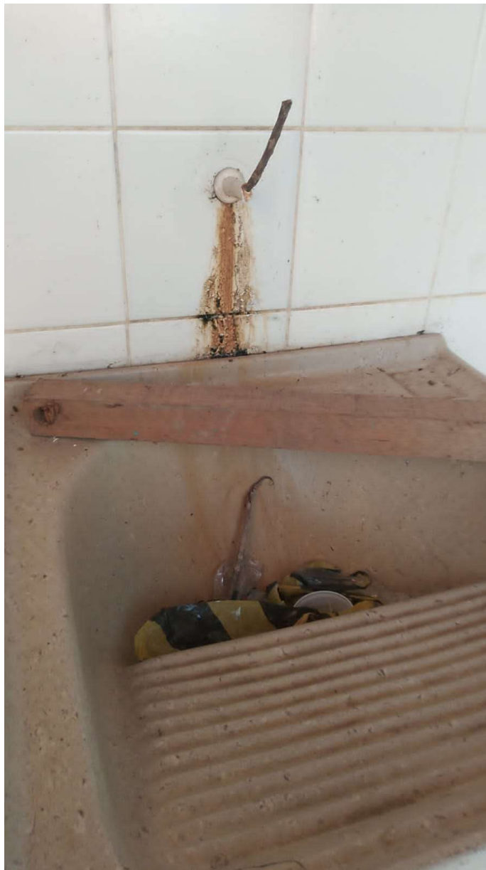
Figura 7 – Pia com torneiras quebradas e com lixo.
