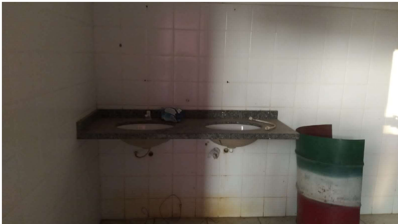
Figura 2 – Pia com defeitos nas torneiras.
