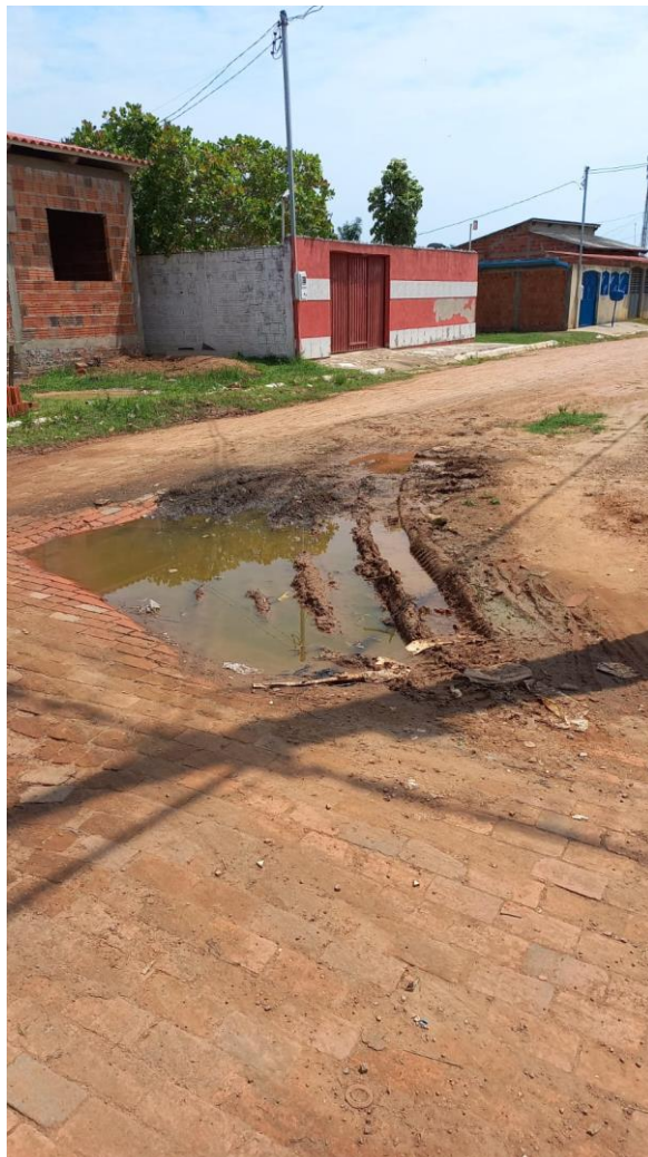
Figura 1 – Pavimentação com buracos e esgoto cheio(entupido).
