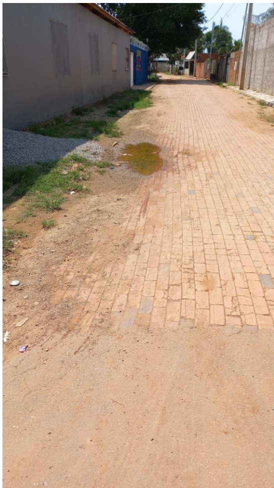
Figura 1 – Rua necessita da manutenção em sua pavimentação.
