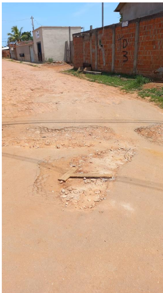
Figura 1 – Pavimentação com buracos e esgoto cheio(entupido).
