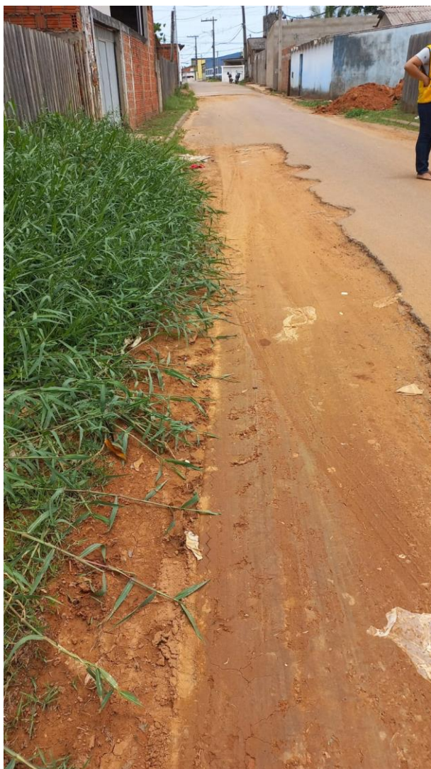
Figura 1 – Pavimentação com buracos, necessidade de limpeza e iluminação pública.
