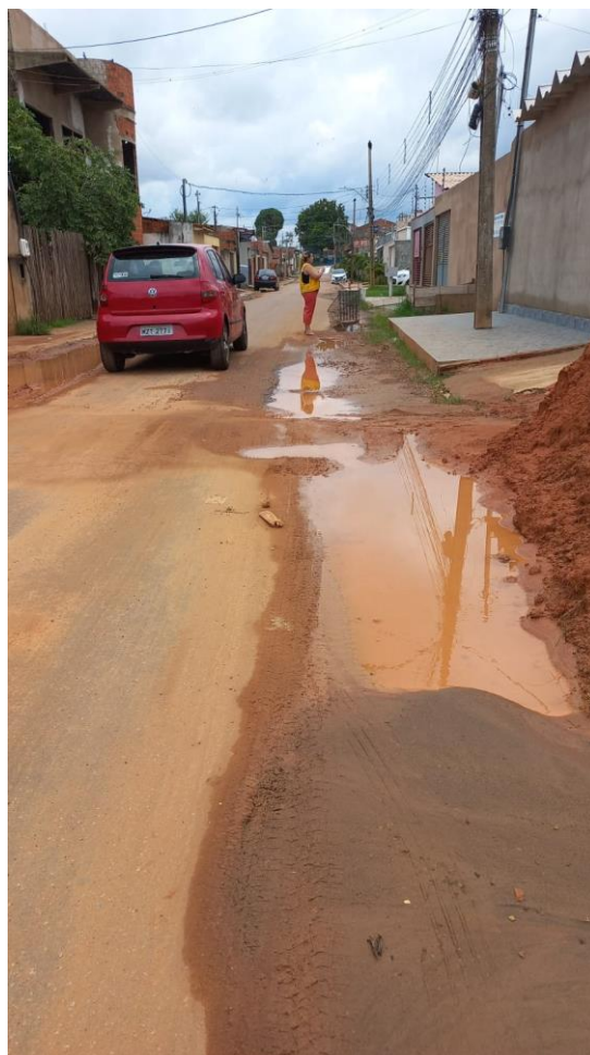
Figura 1 – Pavimentação com buracos e esgoto cheio(entupido).
