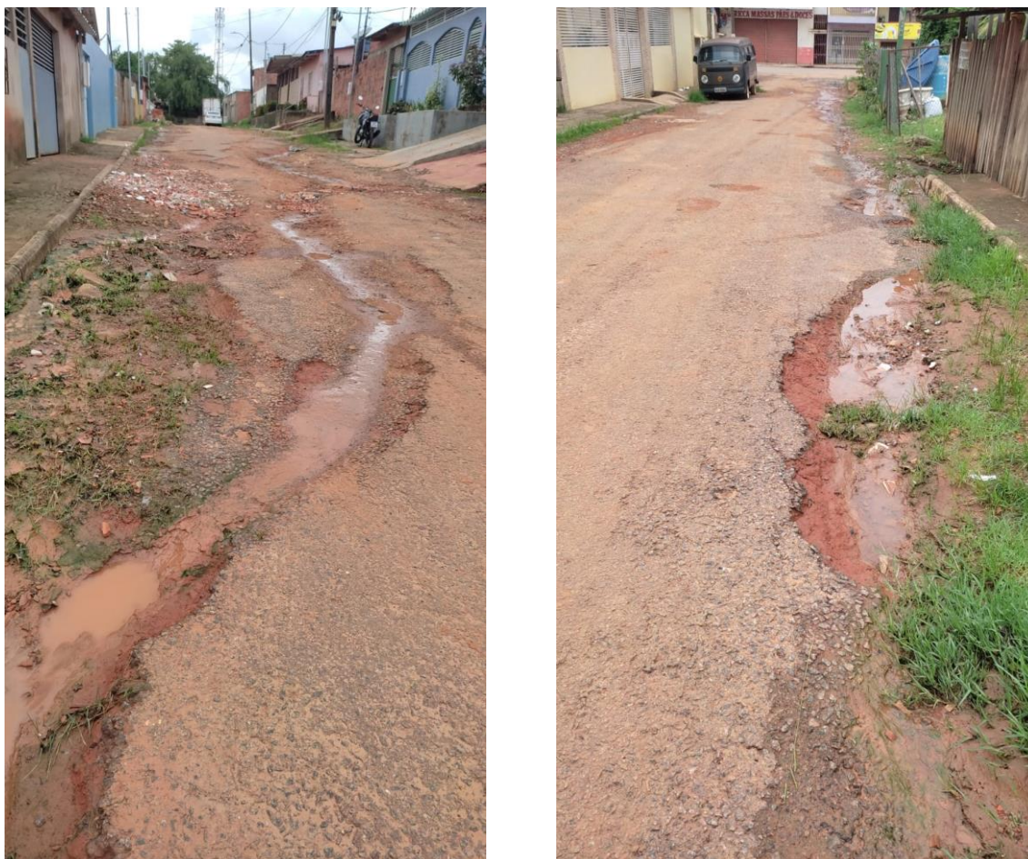
Figura 1 – Pavimentação com buracos e esgoto cheio(entupido).
