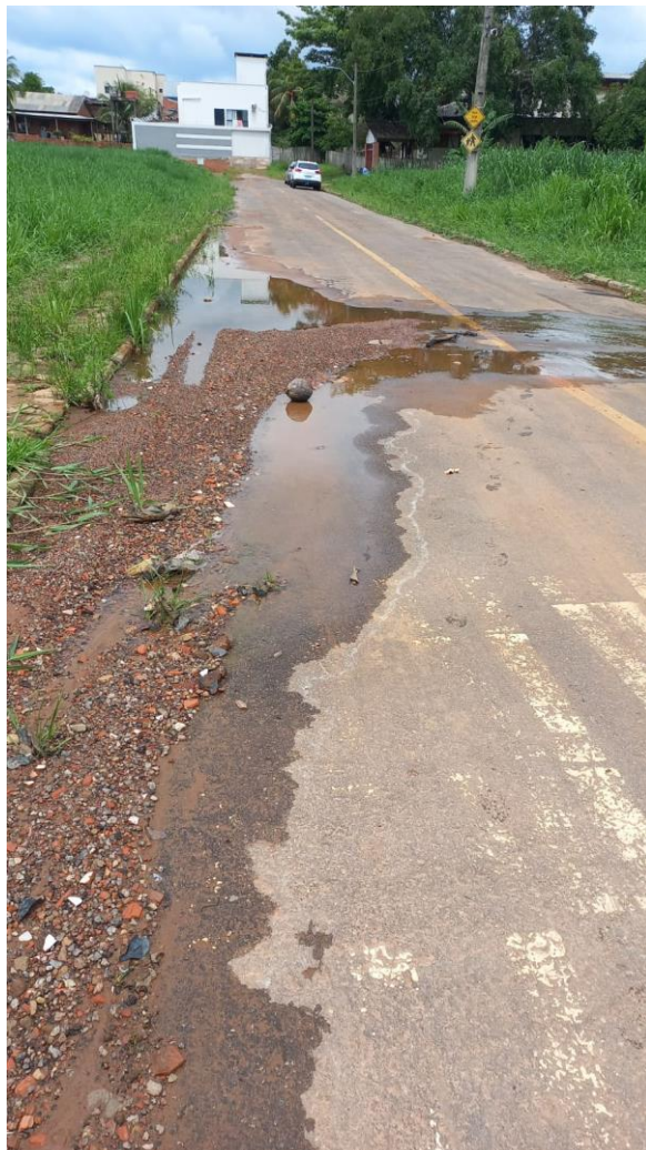
Figura 1 – Pavimentação com buracos e esgoto cheio(entupido).
