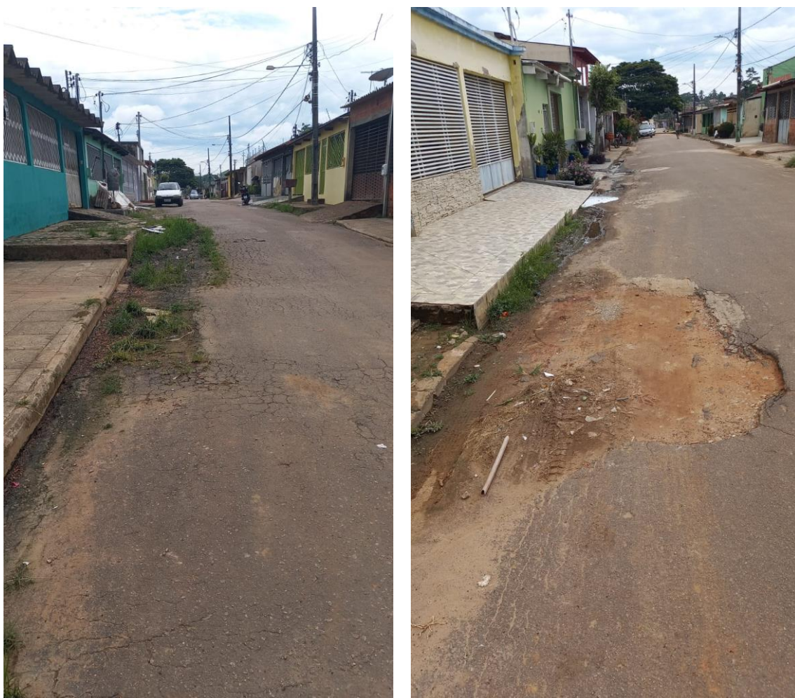
Figura 1 – Pavimentação com buracos e necessidade de limpeza.
