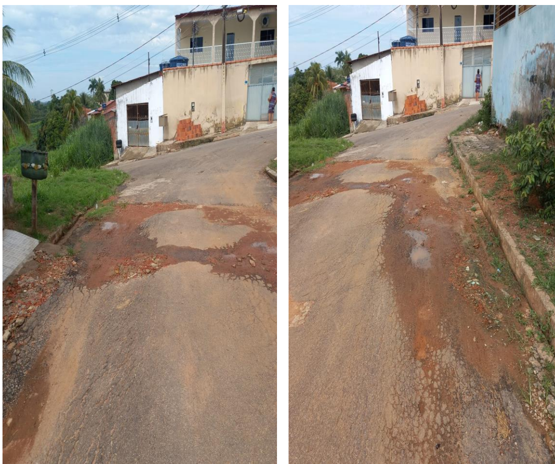
Figura 1 – Pavimentação com buracos e necessidade de limpeza.
