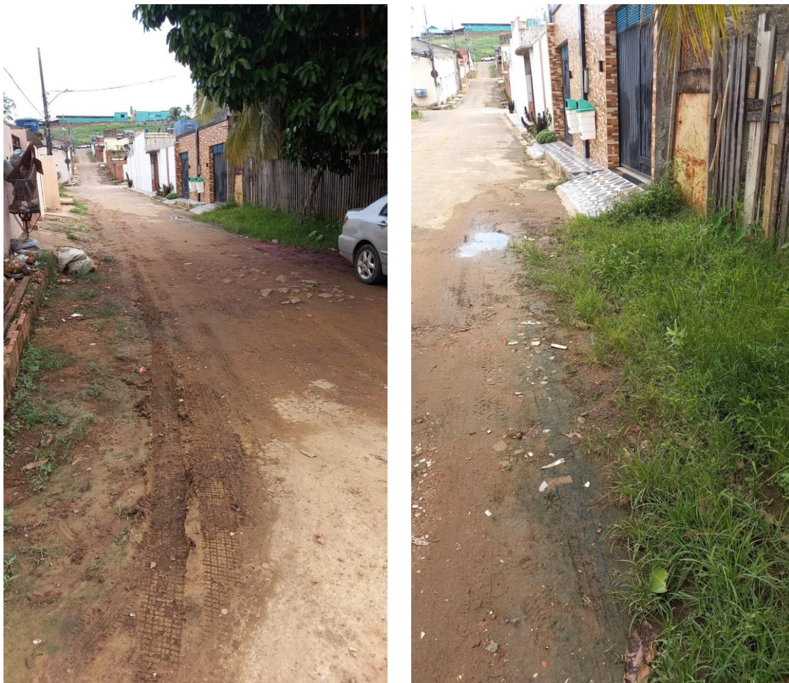
Figura 1 – Pavimentação com buracos e necessidade de limpeza.
