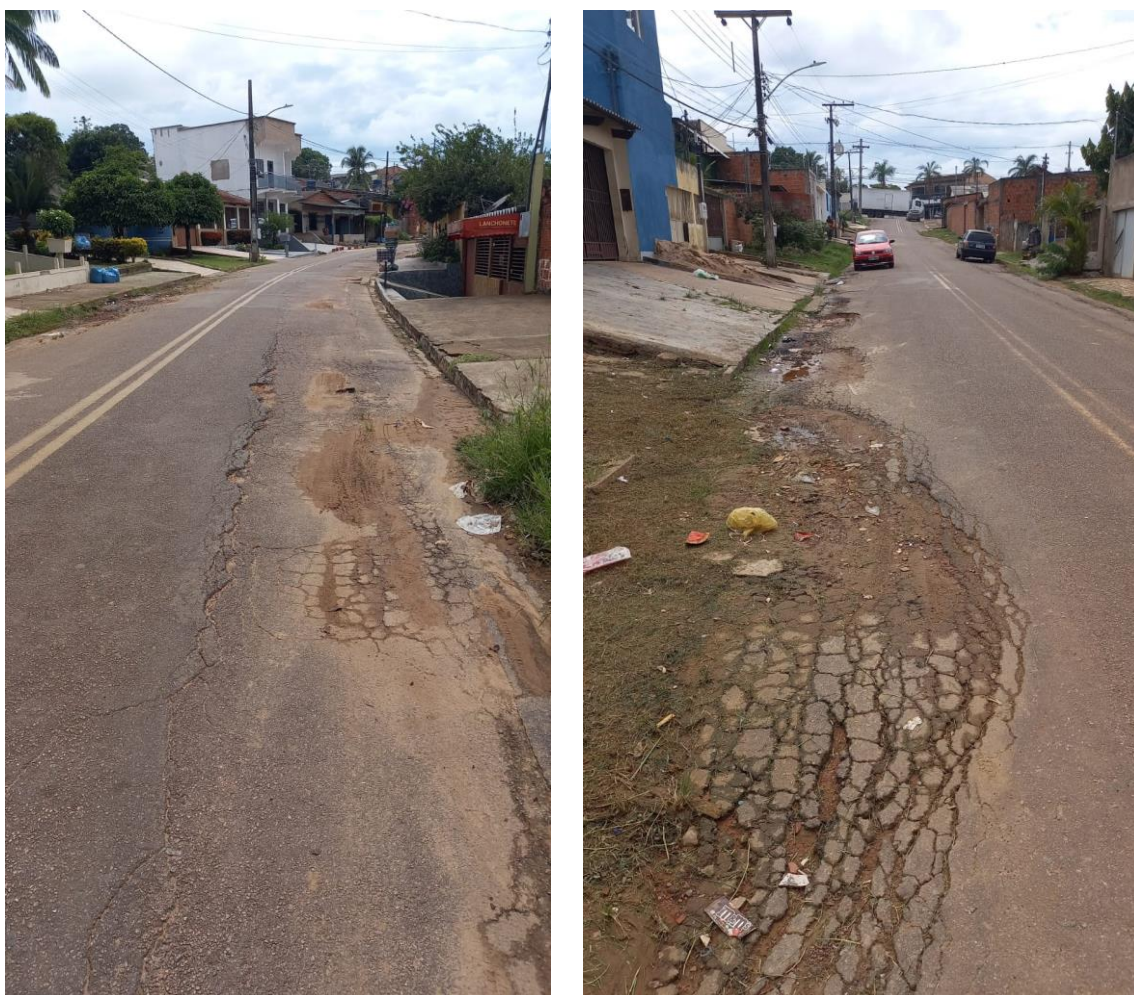
Figura 1 – Pavimentação com buracos e necessidade de limpeza.
