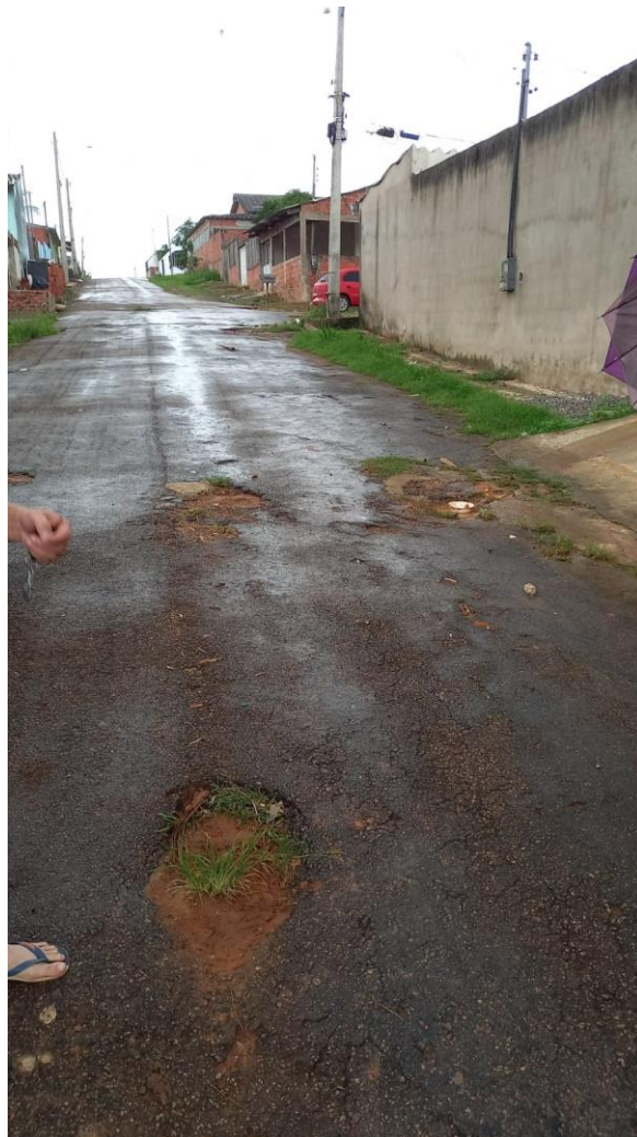
Figura 1 – Rua necessita da manutenção em sua pavimentação.
