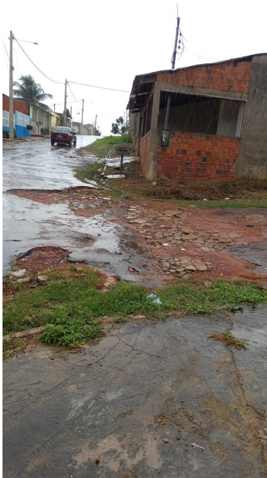
Figura 1 – Rua necessita da manutenção em sua pavimentação.
