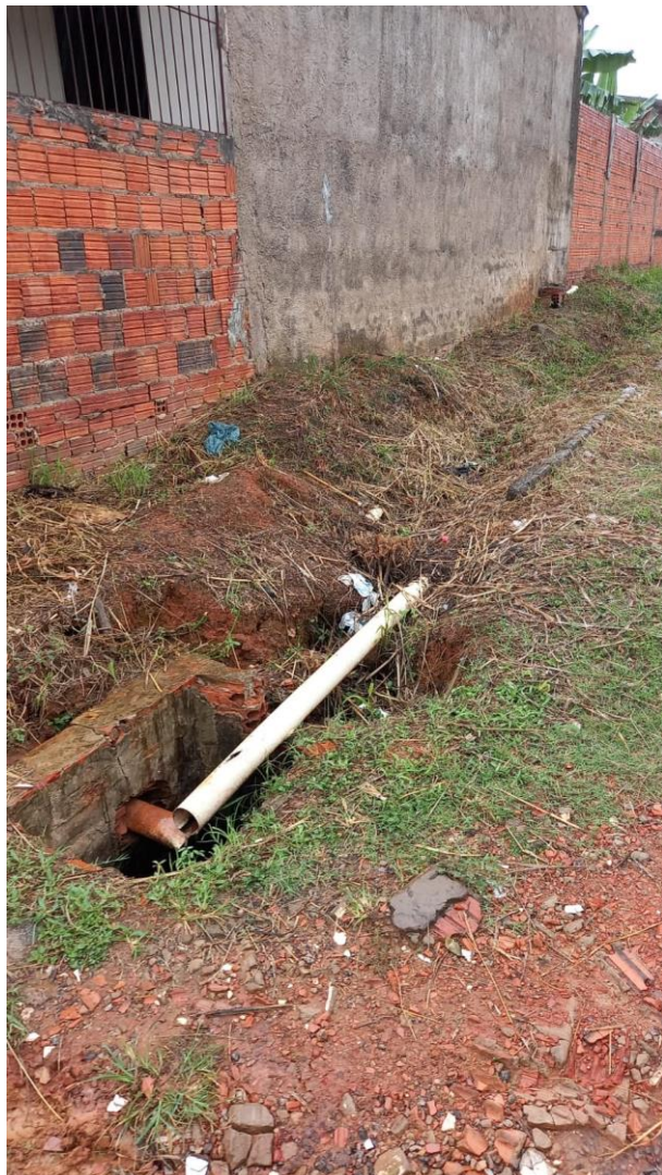
Figura 1 – Pavimentação com buracos e esgoto cheio(entupido).
