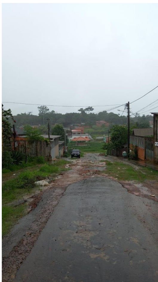
Figura 1 – Rua necessita da manutenção em sua pavimentação.
