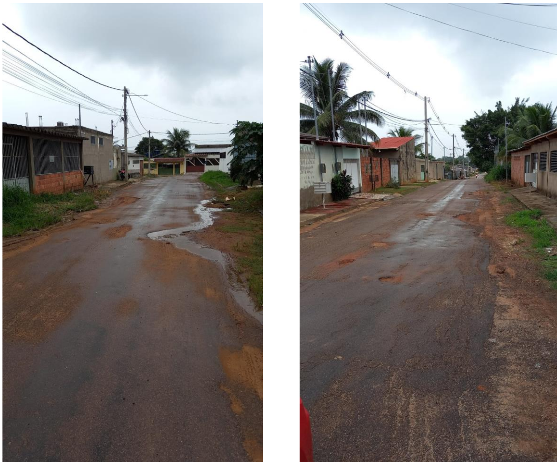
Figura 1 – Rua necessita da manutenção em sua pavimentação.
