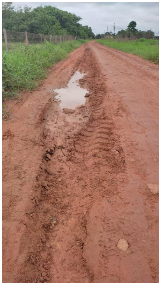
Figura 1 – Pavimentação com buracos.
