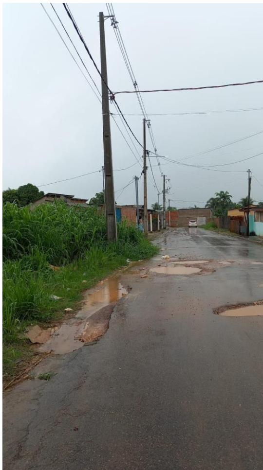
Figura 1 – Pavimentação com buracos e esgoto cheio(entupido).
