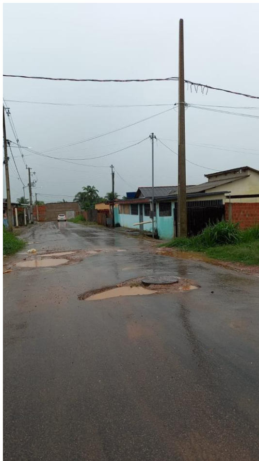
Figura 1 – Rua necessita da manutenção em sua pavimentação.
