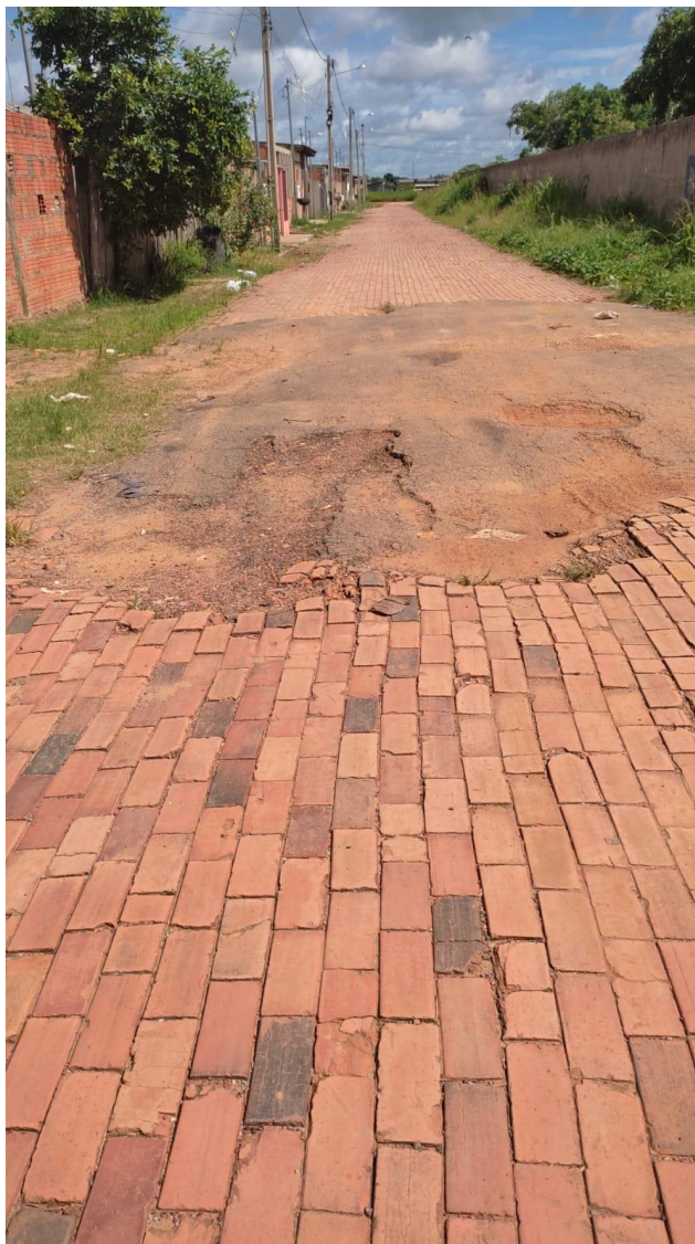
Figura 1 – Rua necessita da manutenção em sua pavimentação.
