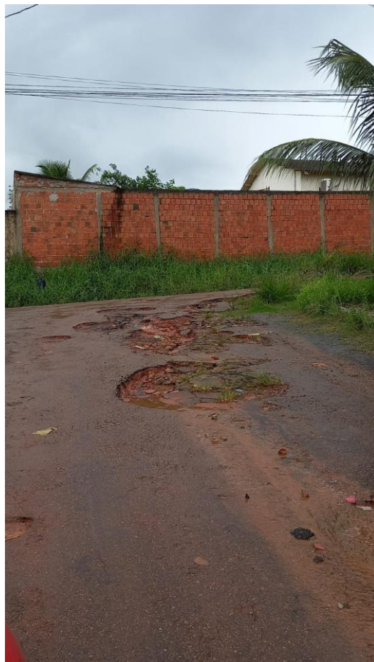
Figura 1 – Rua necessita da manutenção em sua pavimentação.
