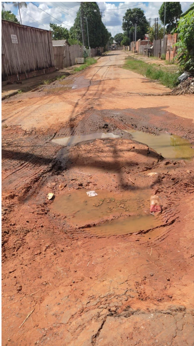
Figura 1 – Rua necessita da manutenção em sua pavimentação.
