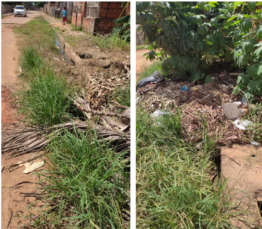
Figura 1 – Necessidade de limpeza e roçagem.
