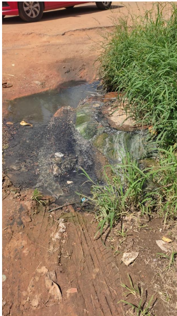
Figura 1 – Pavimentação com buracos e esgoto cheio(entupido).
