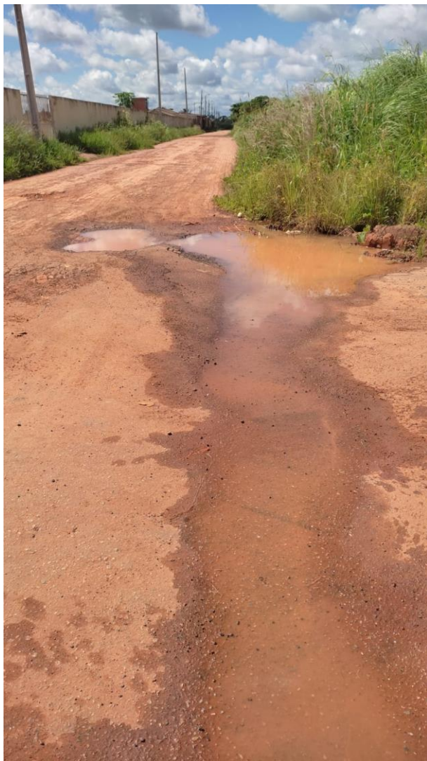
Figura 1 – Rua necessita da manutenção em sua pavimentação.
