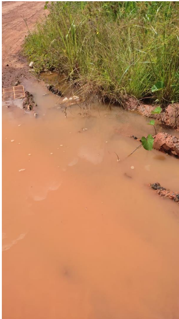
Figura 1 – Pavimentação com buracos e esgoto cheio(entupido).
