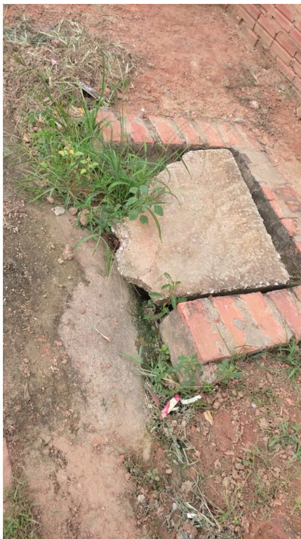
Figura 1 – Pavimentação com buracos e esgoto cheio(entupido).
