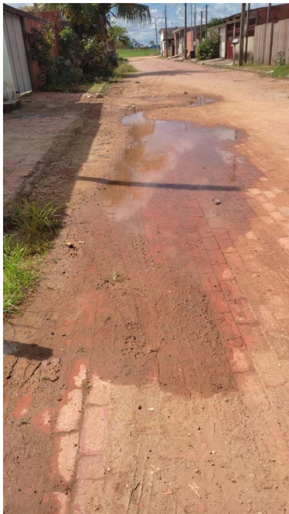
Figura 1 – Rua necessita da manutenção em sua pavimentação.
